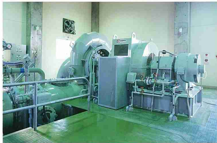
安川発電所水車発電機
