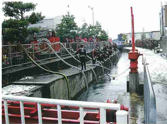
防火用水（二万石用水路）
