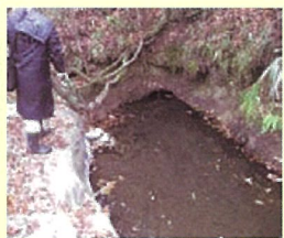
小平隧道出口
